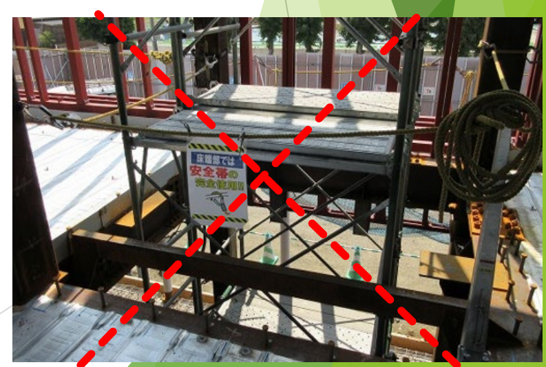
「トラロープで区画(ELV開口)❌」
