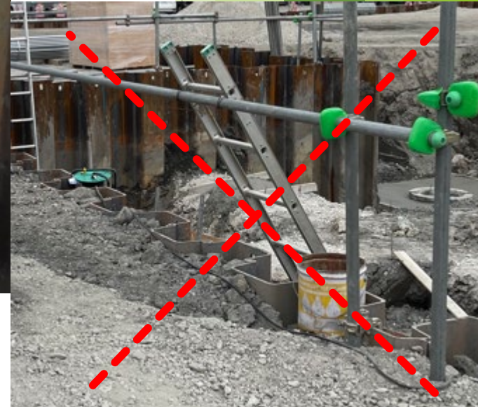
「法肩が崩れて 手すりを超えて崩壊」
