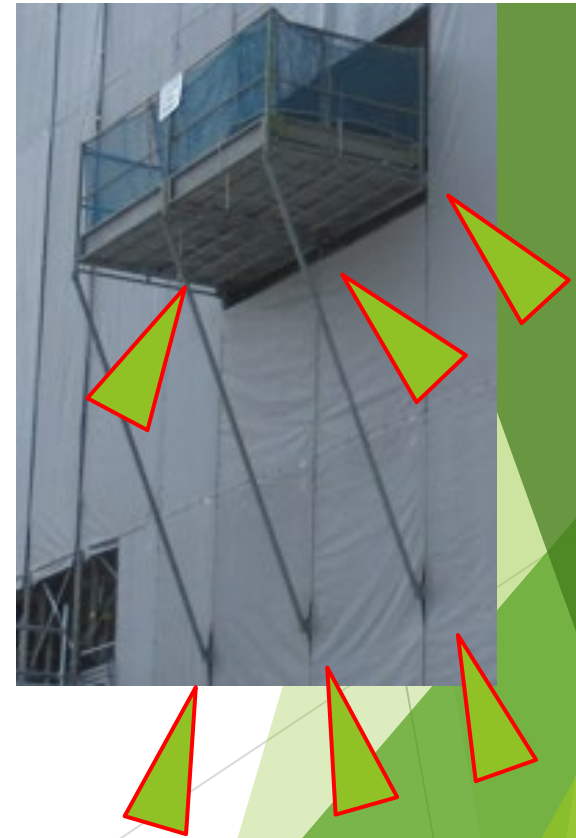
ハンガーステージ部の支持部 → 支柱毎に壁つなぎを増設・要。
